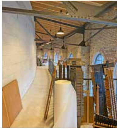
Das Halbrund der Außenwände setzen Daniela und Thomas bei der Sanierung im Innenbereich fort.
