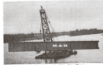
Bild 6: Eisenkranne der linken Seitenöffnung
